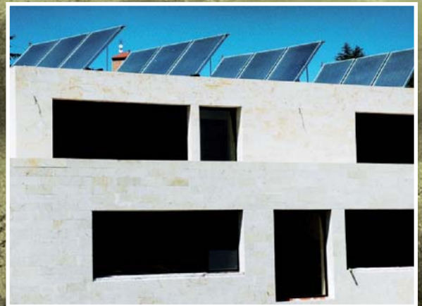
Instalaciones con Captadores Solares Termicol
